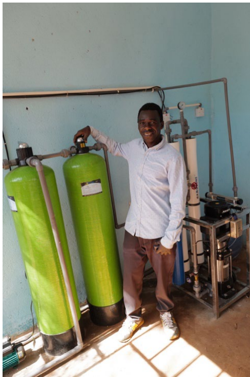
Der „Wassermann“ Omari neben der Filteranlage des Krankenhauses in Mnero
