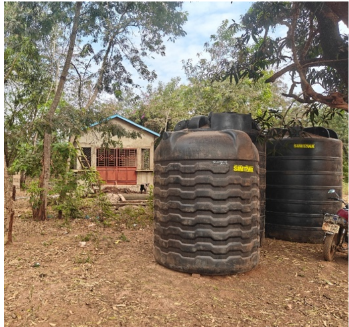
Neue Wassertanks und ein neuer Technikraum zur Wasseraufbereitung in Mnero
