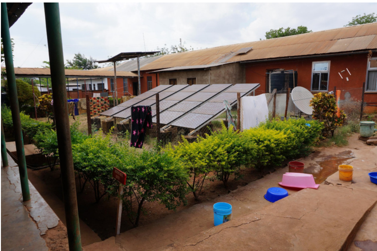
Solaranlage im Hospital Innenhof
